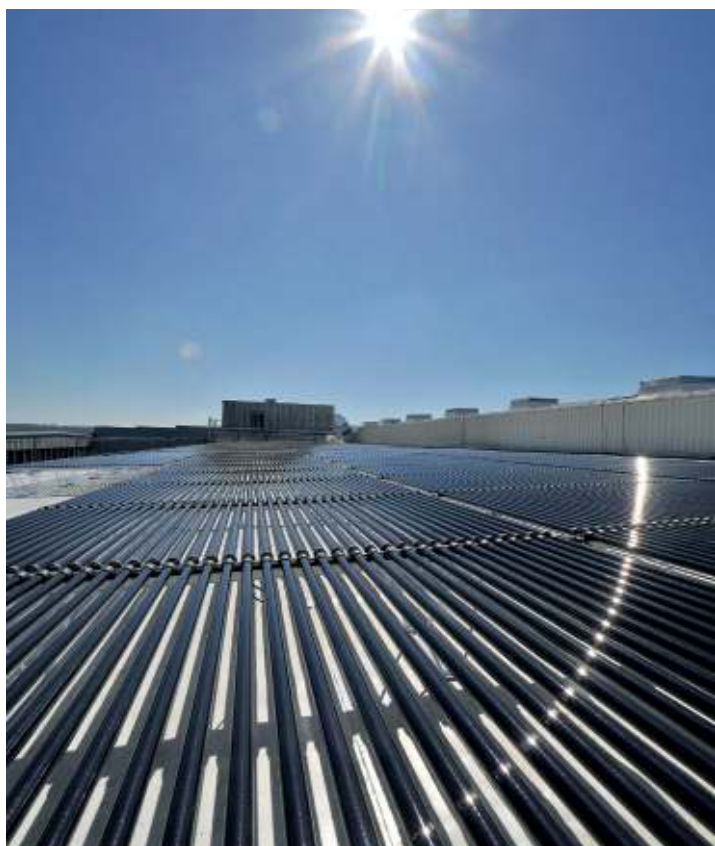
Střecha závodu slouží k získávání solární energie
